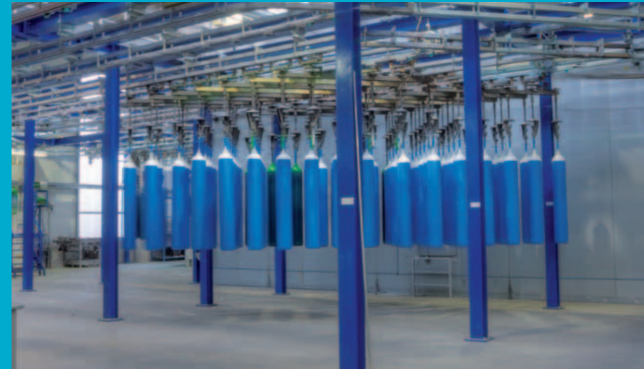
Pulverbeschichtung und Lackierstraße Powder coating and paint spraying line
